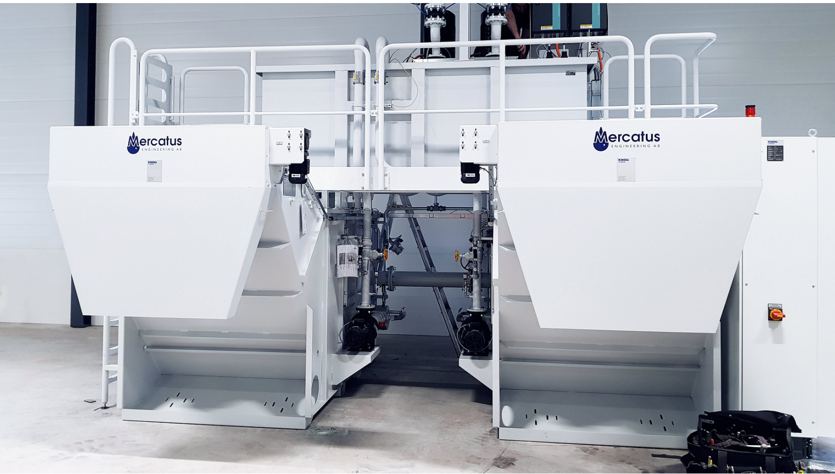
Central skärvätskereningsanläggning 2xVRF900
