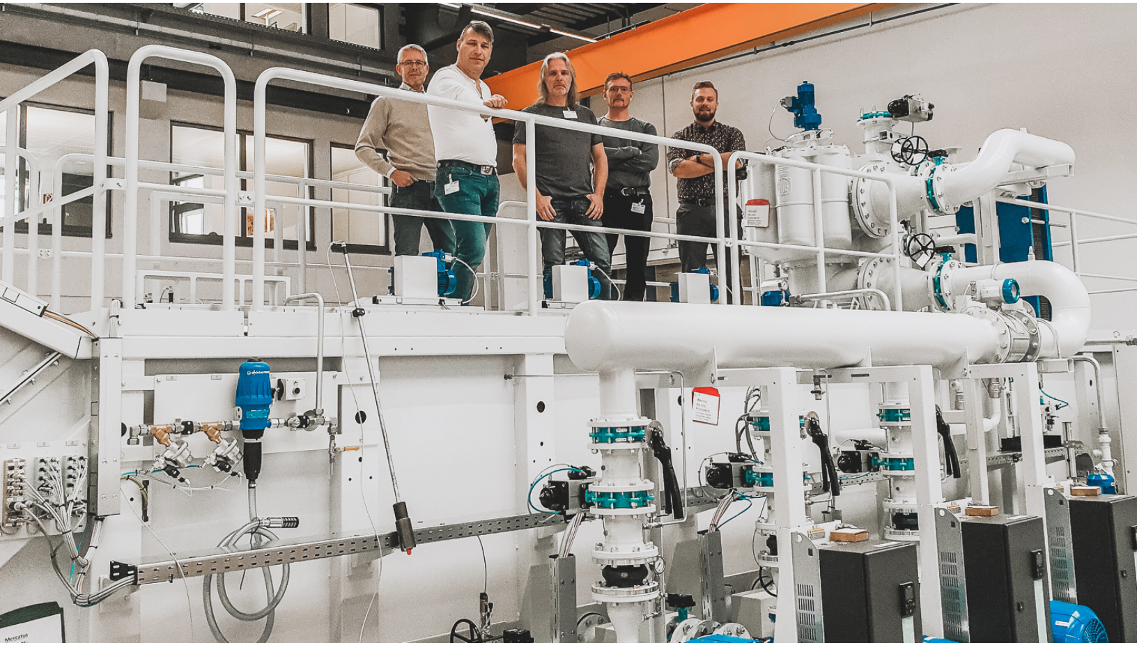
FAT-test av central skärvätskereningsanläggning hos Knoll Maschinenbau GmbH.
