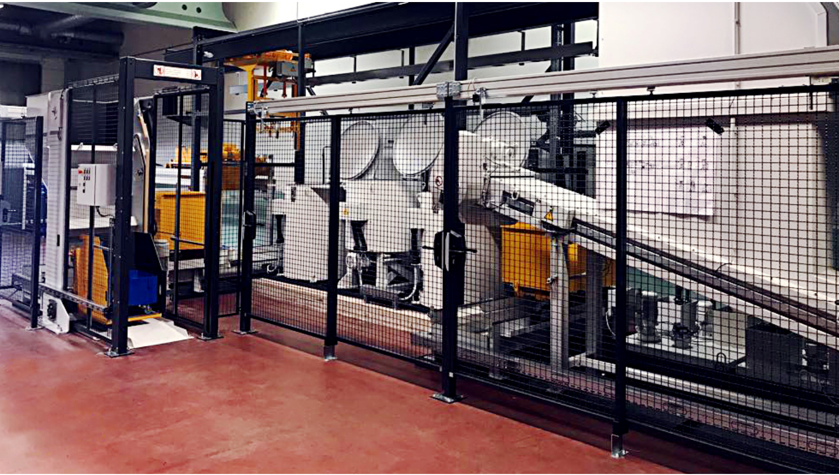
Spåncentrifugeringsanläggning hos Gnosjö Automatsvarvning
